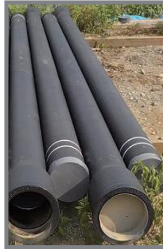
(新しい水道管)
