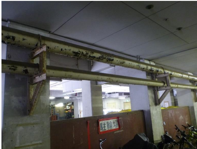
▲配管類の腐食
