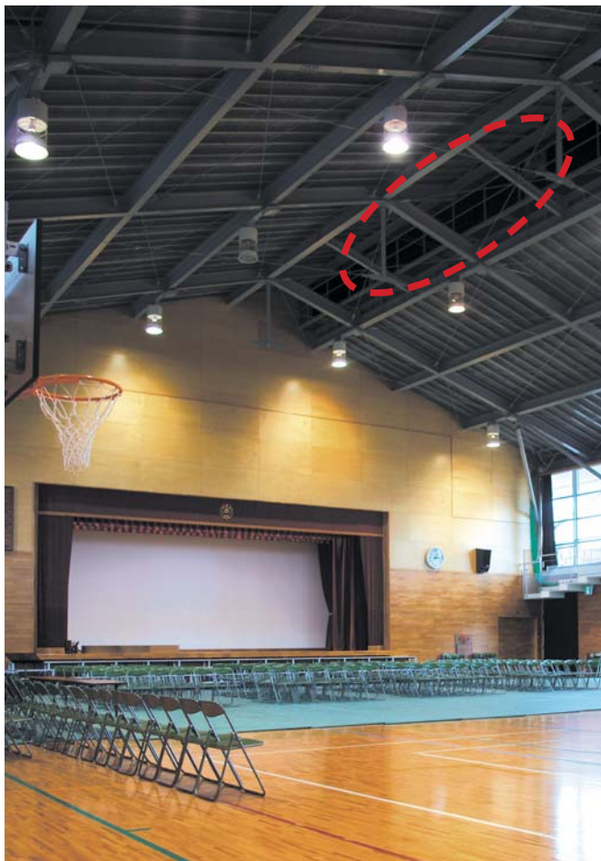
10 室内外の温度差により生じる気圧差を利用した重力換気システムを設けた体育館
