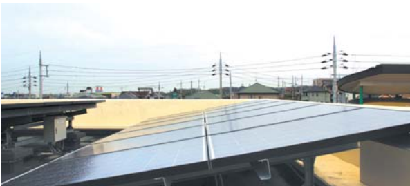
7 太陽光パネル
