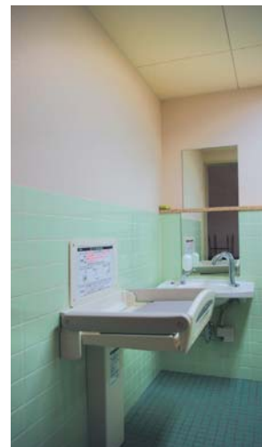
13 「だれでもトイレ」内のベビーシート
