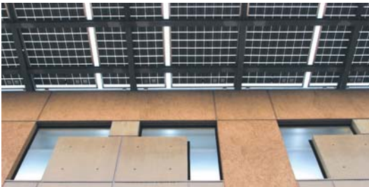
6 半透過型の太陽光パネルを採用した庇
