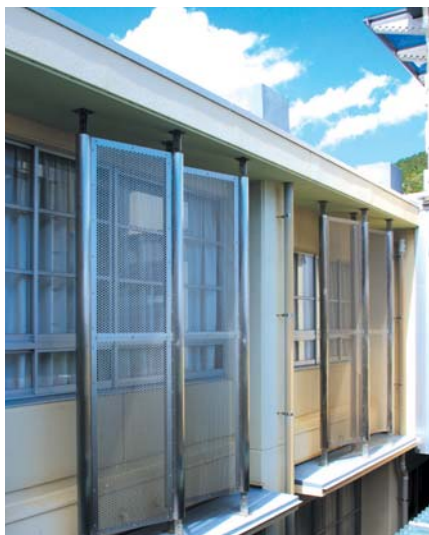
11 室内の温度上昇を防ぐルーバー
