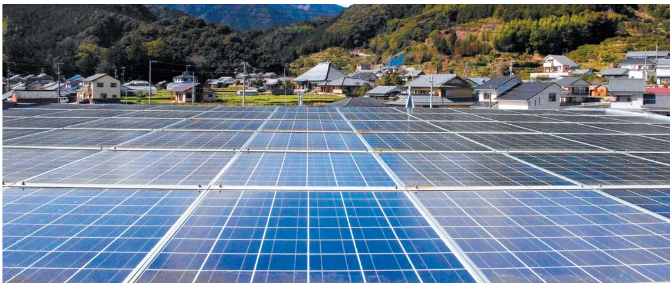
9 屋上に設置された太陽光パネル
