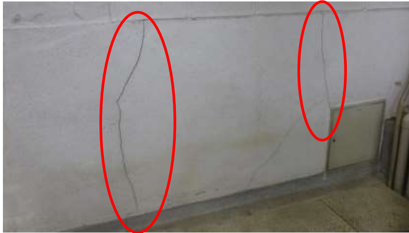
市役所A・B棟壁のひび割れ
