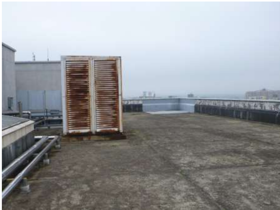
市役所A・B棟屋上防水の劣化
