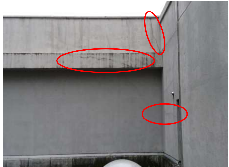
市役所A・B棟の外壁のひび割れ
