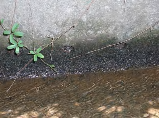
U字溝孔から水は出てない
