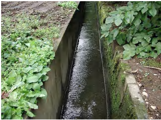
U字溝接目から湧水
