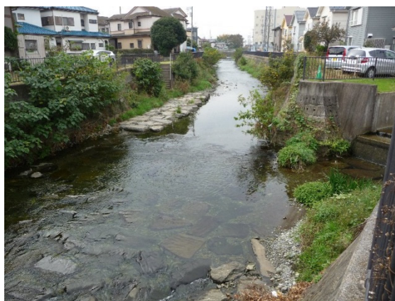
河床には礫や土砂が堆積している
