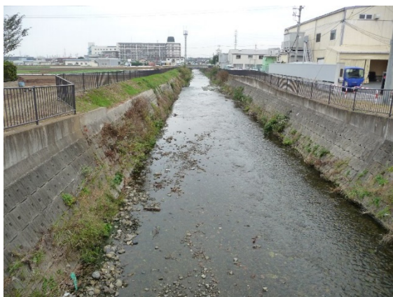
河床には礫や土砂が堆積している
