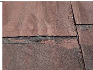
1号棟 防水材 浮き 目地 劣化
