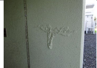
3号棟 外壁 浮き
