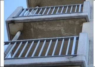
バルコニー天井のひび割れ
