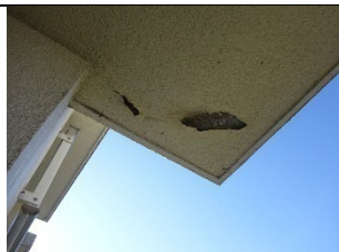
階段室天井 塗装剥離
