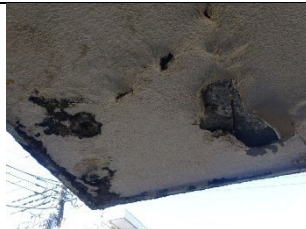
1号棟 階段室天井 塗装浮き、剥離
