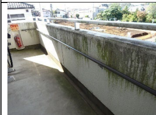
廊下 手すり壁 汚れ
