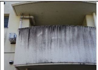
2号棟 外壁 汚れ
