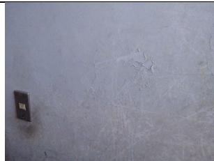
階段室 壁の塗装剥離
