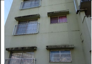
1号棟 窓庇 汚れ
