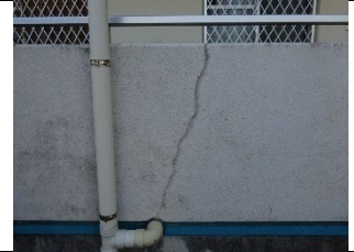
外壁のひび割れ
