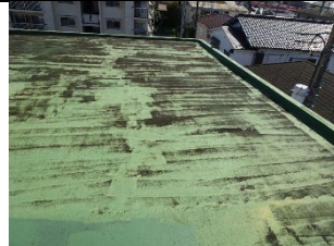
2号棟 塗膜防水 劣化
