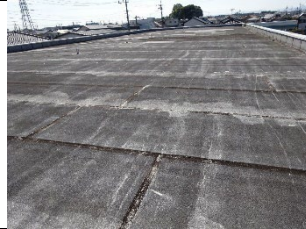
屋上 目地の劣化
