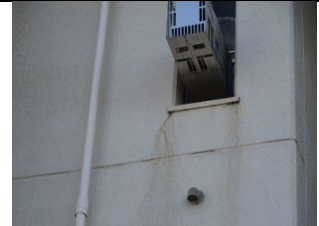
2号棟 外壁 ひび割れ
