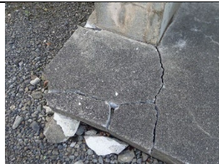
7号棟 階段室入口 たたき破損
