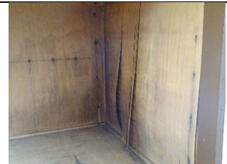
5号棟 押入 木材の剥がれ
