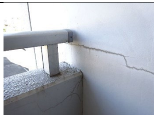
1号棟 階段室 ひび割れ
