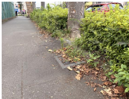
集水桝の詰まり
