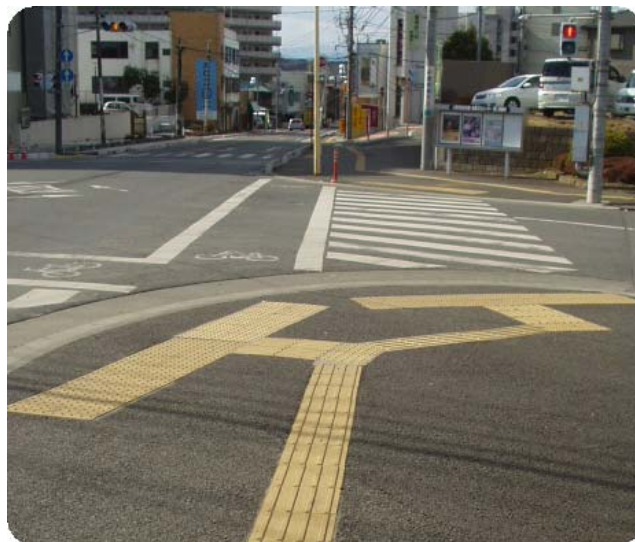
入間市役所前交差点の点字ブロック
