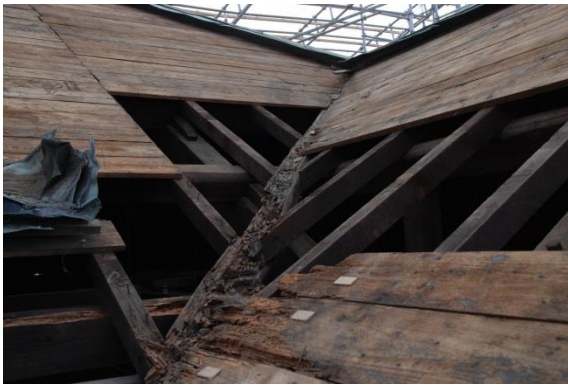
屋根小屋組腐朽状況
