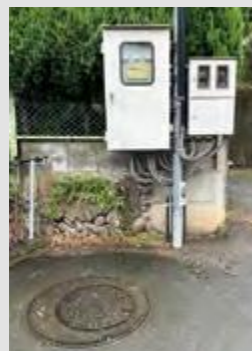
マンホールポンプ制御盤
