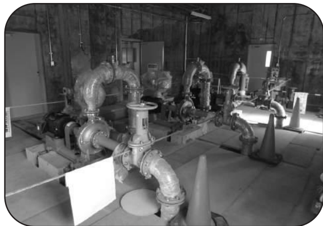
ポンプ棟内部の様子
