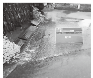
漏水発生状況
