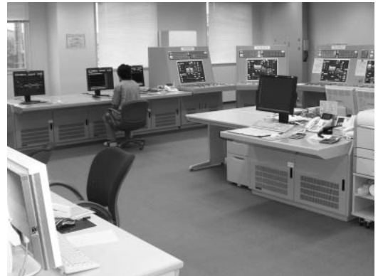
中央監視制御設備室
