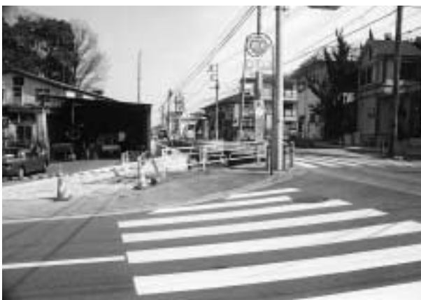
上仏子の県道・富岡入間線の石黒製作所付近の側道整備工事の様
