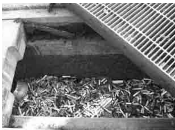
武蔵藤沢駅東口前の側溝に捨てられた吸殻
