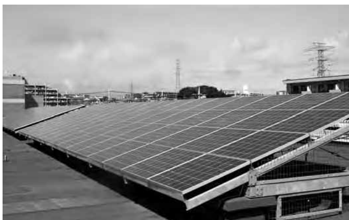
藤沢公民館に設置されている太陽光発電パネル
