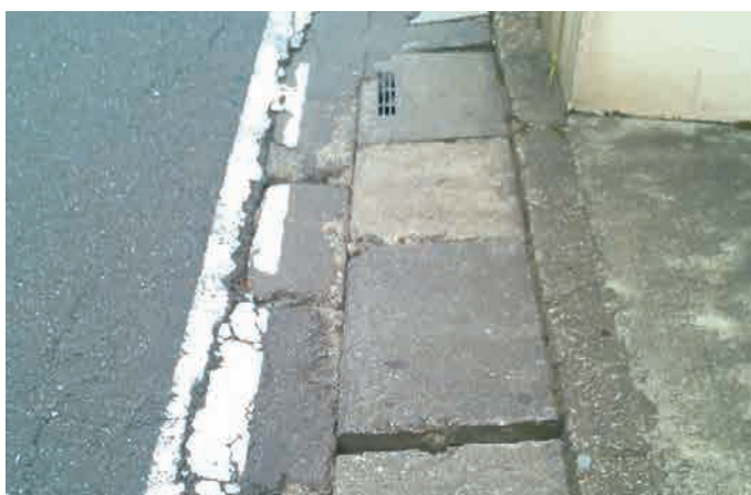
側溝蓋・路側帯の傷みにより危険な扇町屋交差点付近の県道青梅入間線
