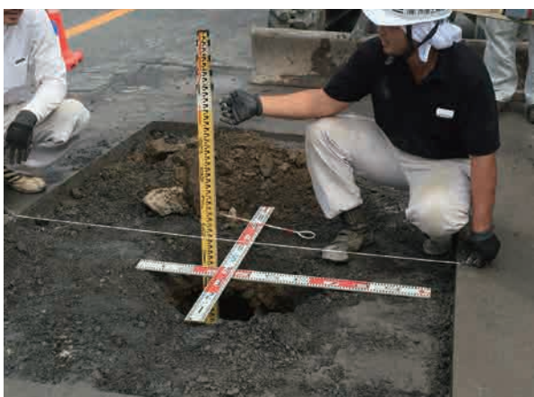
開削調査の結果、発見された空洞
