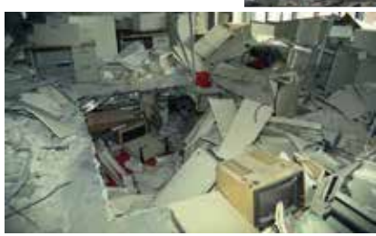
地震で6階(水道局)が圧壊した神戸市役所2号館他(写真提供:神戸市)
