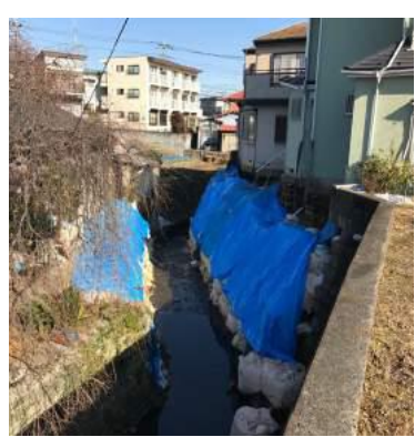
崩落した野田の藤田堀
