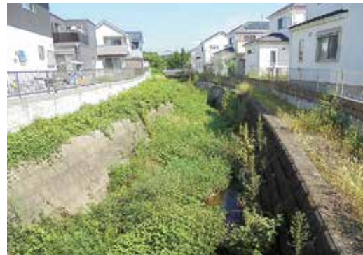
土砂が堆積した前堀川
