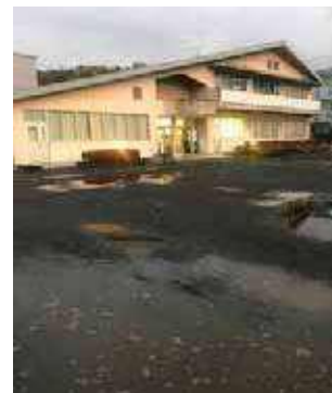
路面が傷み、凹みがある事から少量の雨でも水たまりができてしまう駐車場
