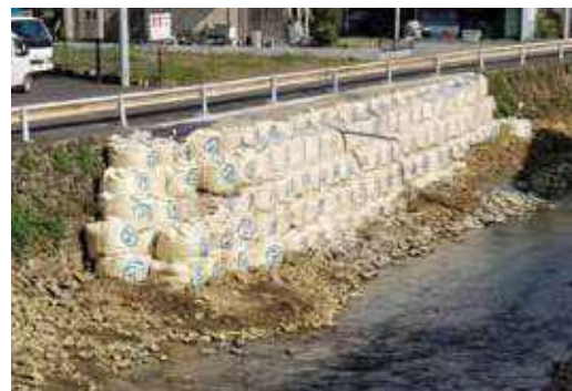
台風第19号による応急補修後の霞川八瀬橋から東側の護岸
