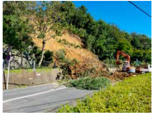
斜面が崩落した金子坂（2019年10月）
