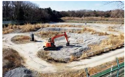
令和10年頃に埋め立て完了予定の最終処分場埋立地（面積16,350㎡）
