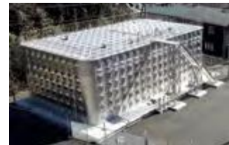
新「西武第一配水池」提供 水道施設課
