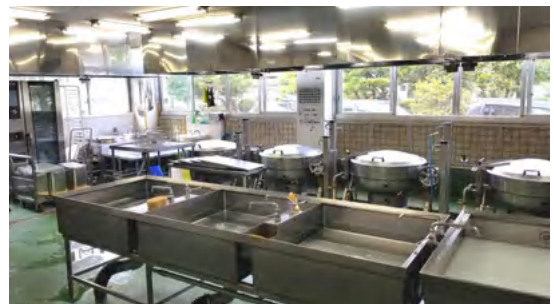
早期のエアコン設置が求められる給食調理室【写真は金子小学校の給食調理室】
