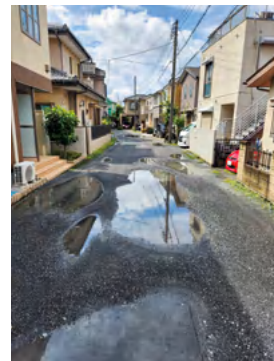
未舗装で水たまりに30年以上悩まされる東藤沢地区内の行き止まり私道
