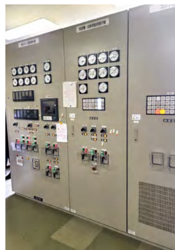
配水場内の監視操作盤
