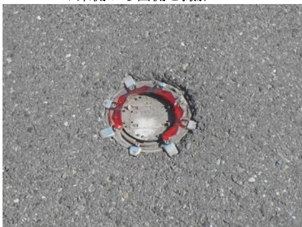
↑交差点の中心 点滅ランプ故障中
